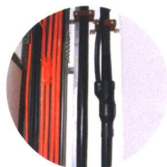
建筑电气竖井 配电应用
