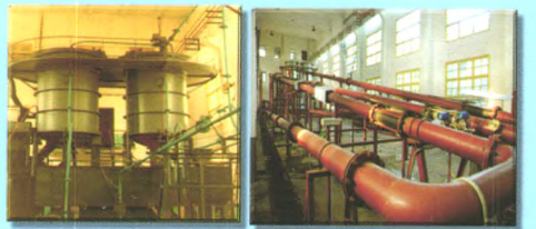
管道输送试验系统
