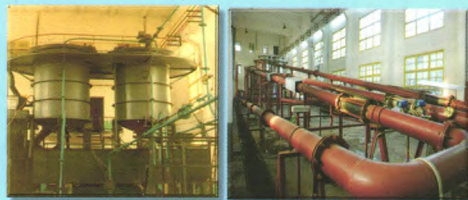
管道输送试验系统
