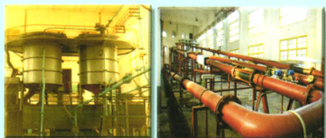
管道输送试验系统
