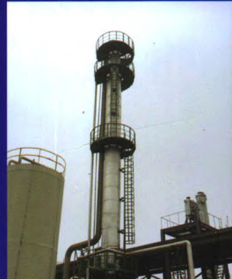
800吨/天氨氮废水处理工程
