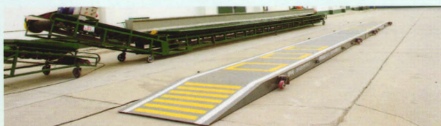
单边桥、除尘卸粮机
