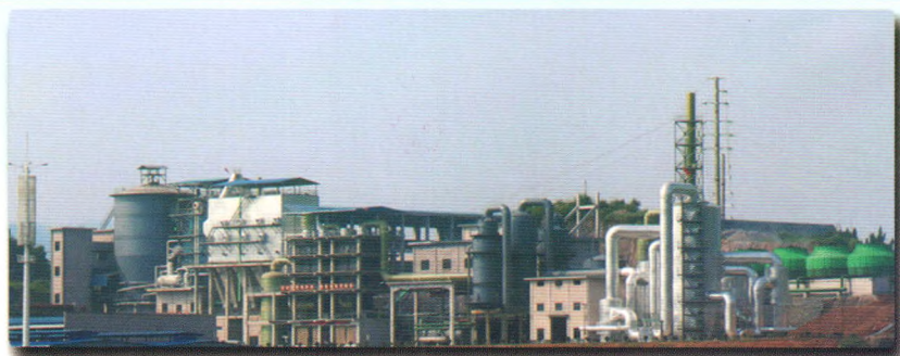
80m 2 沸腾焙烧锌精矿脱硫制硫酸装置
