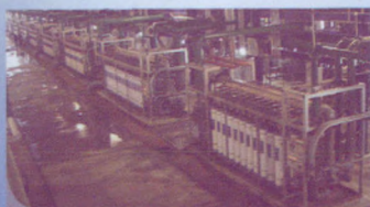
中石化某大乙烯项目 投运时间: 2008年 超滤产水量: 54000m 3 /d 膜组件数量: 560支 水源: 地表水/淡化水
