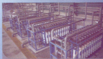
辽宁某矿业项目 投运时间: 2009年 超滤产水量: 12500m 3 /d 膜组件数量: 168支 水源: 矿井疏干水
