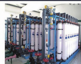
采油厂污水处理
