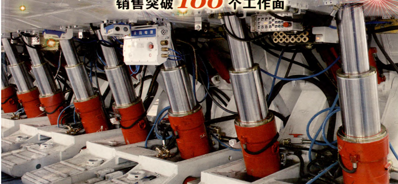
液压支架电液控制系统
