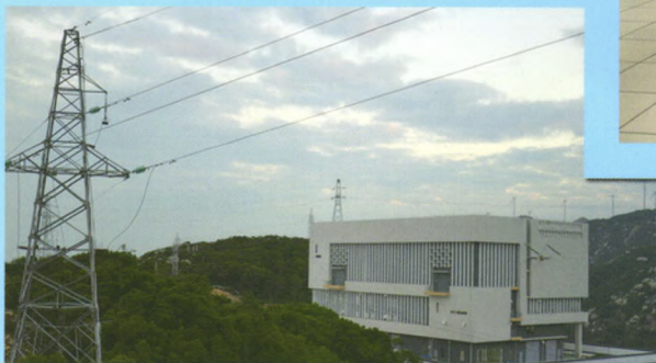
世界首个多端柔性直流输电工程——青澳换流站
