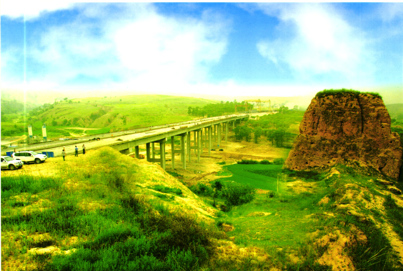
长城古烽火台下的呼和浩特—杀虎口高速公路二十四湾大桥施工现场
