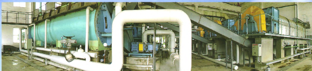
污泥脱水干化系统设备
