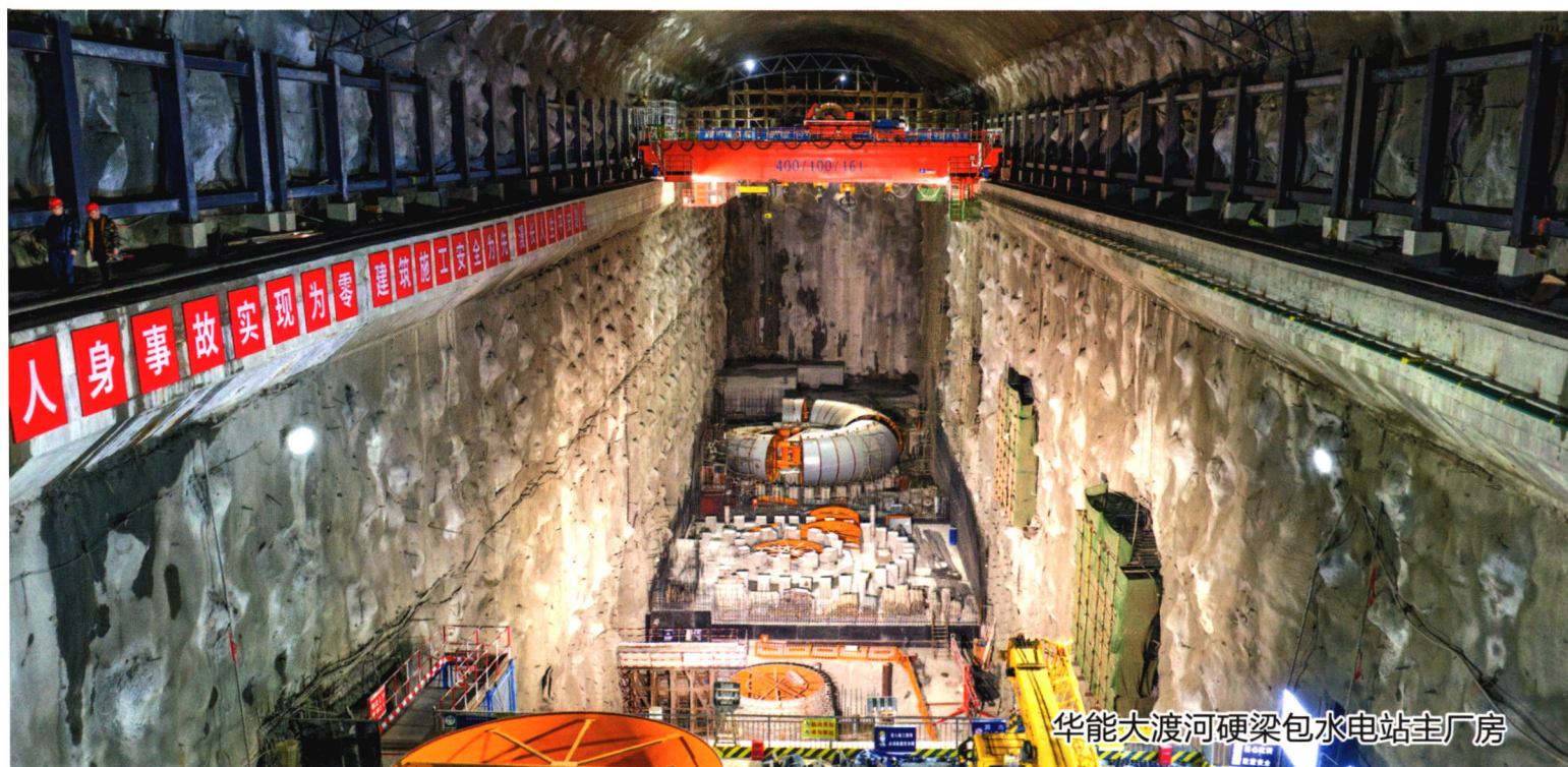
华能大渡河硬梁包水电站首部枢纽
