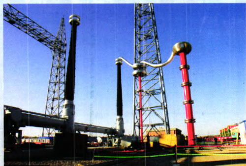
● 1000 kV GIS主回路绝缘试验
