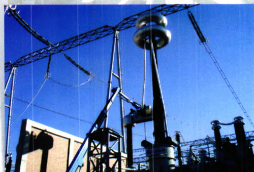
● 1000 kV变压器外施耐压试验
