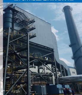
国内某铝业超低排放项目
