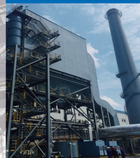
国内某铝业超低排放项目
