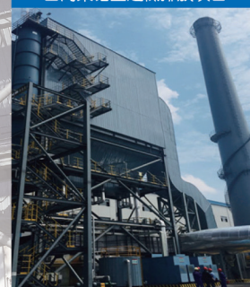
国内某铝业超低排放项目
