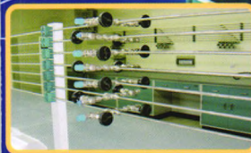
实验室供气系统
