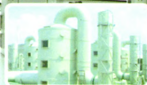
实验室废水废气处理工程
