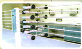
实验室供气系统
