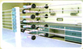
实验室供气系统
