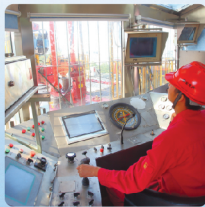
司钻集成控制系统、监控系统
