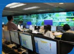
管材数据中心
