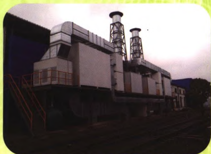
VOCs有机废气净化系统
