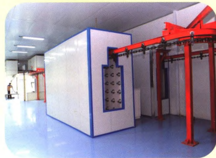
悬挂式喷漆生产线
