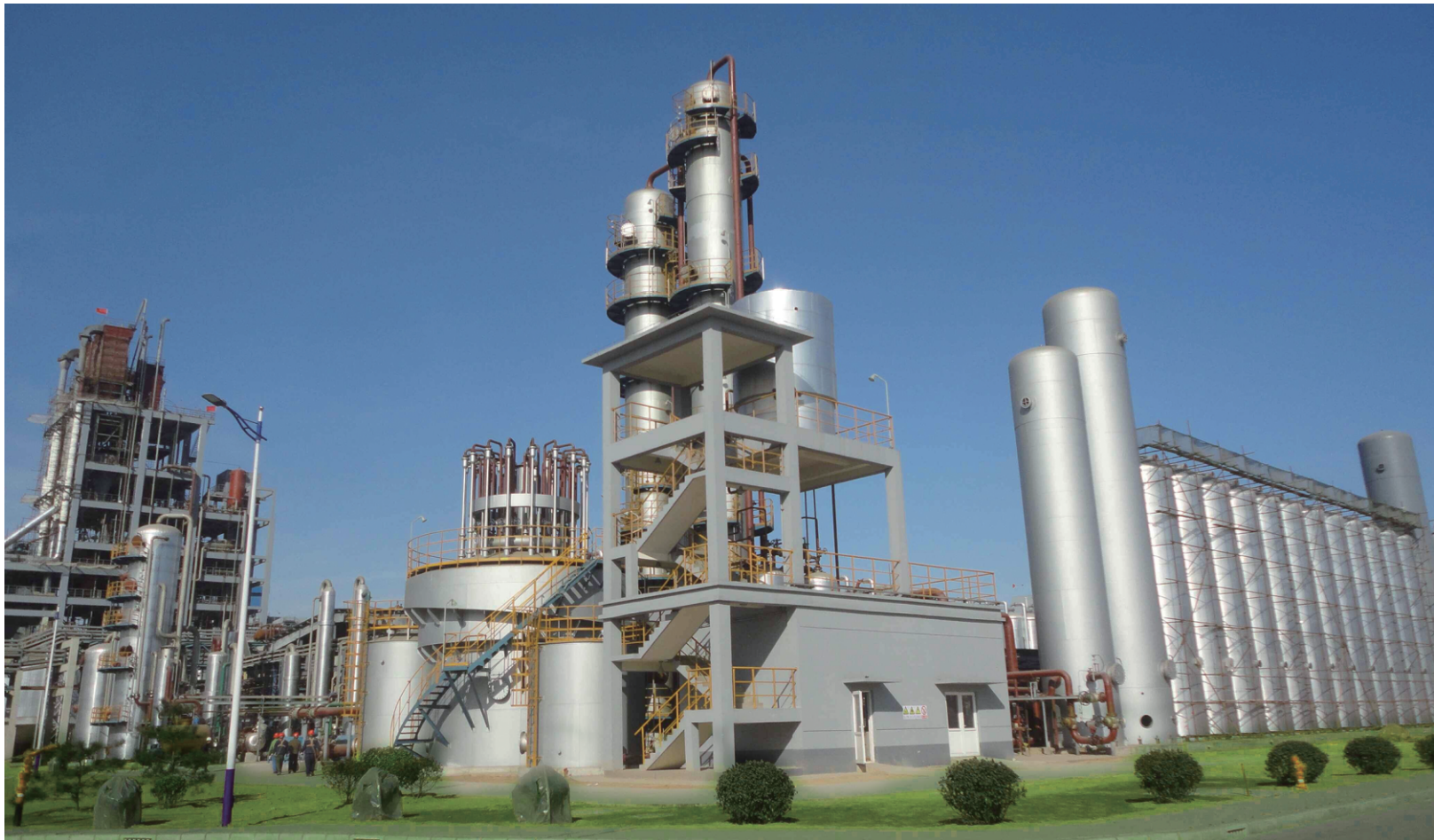
西南化工研究设计院有限公司提供技术的工业排放气合成乙二醇工业装置
