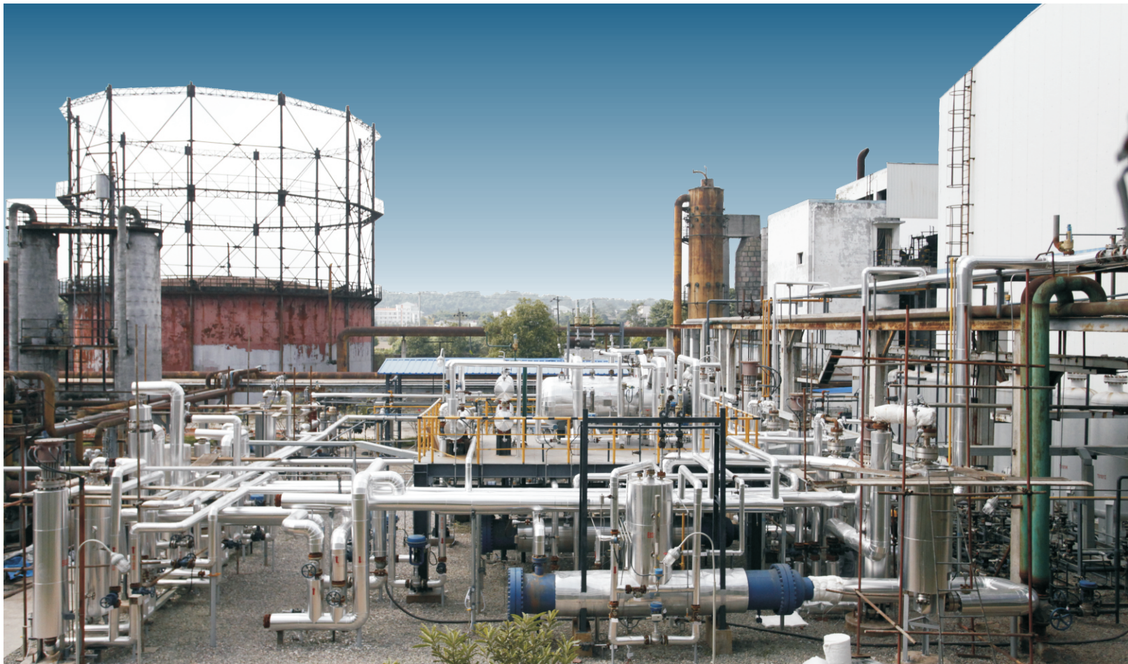
西南化工研究设计院有限公司煤制天然气甲烷化中试装置
