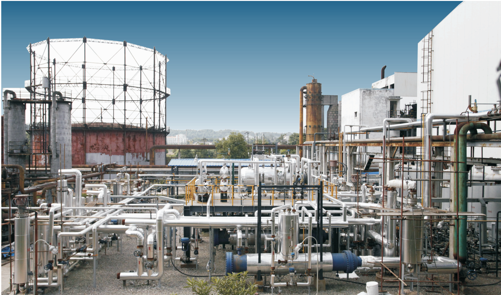
西南化工研究设计院有限公司煤制天然气甲烷化中试装置
