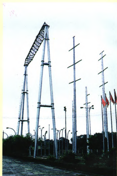
▲ 变电架构输电杆
