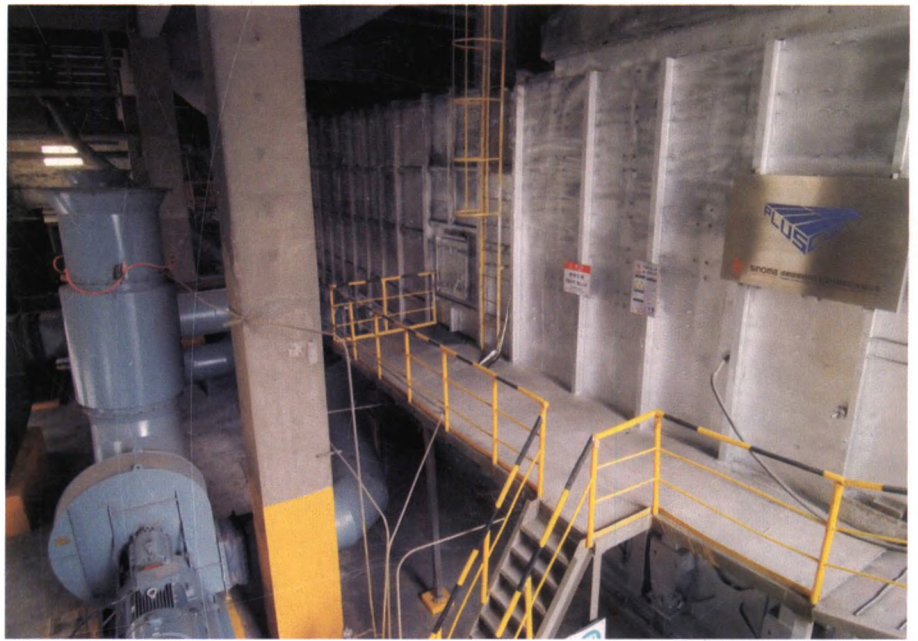
PULS篦冷机运行中
