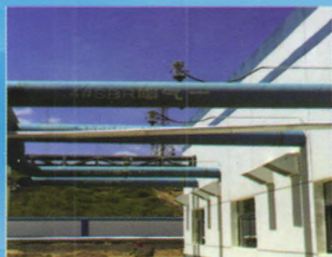
中国石油吉林石化公司炼油厂柴油质量升级项目动力站
