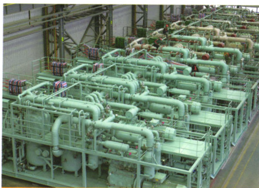
再液化装置(Reliquefaction unit)
