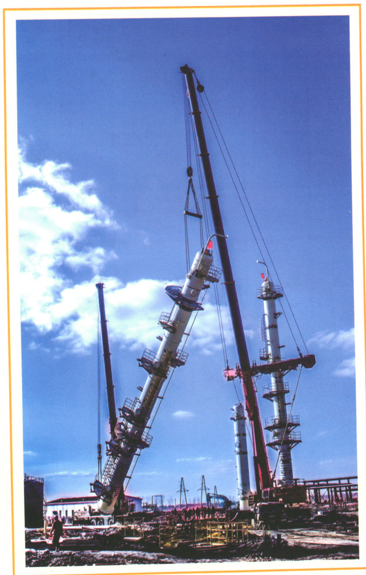
大庆油田设计院总承包的大庆徐深天然气净化厂工程
