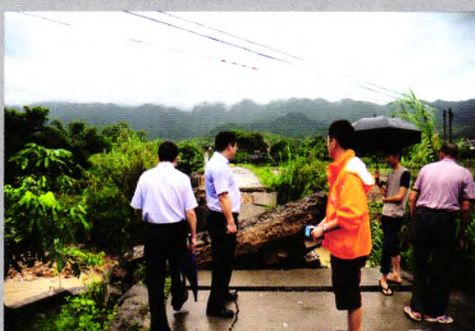
“尤特”台风造成同安澳溪村桥梁坍塌，厦门人保财险理赔人员冒雨赶往现场。
