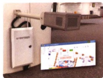
微小气候监测系统
