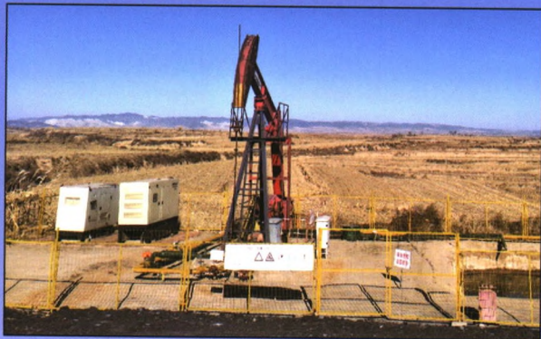
煤层气监控系统
