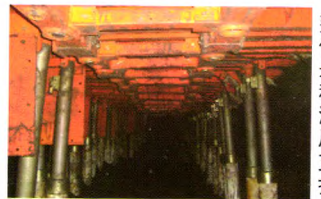
整体悬移液压支护
