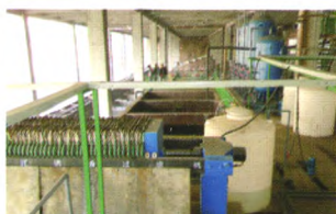
离子交换装置
