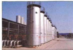
4600Nm 3 /h 变压吸附分离一氧化碳装置
