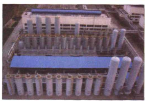
10500Nm 3 /h 变压吸附分离一氧化碳装置
