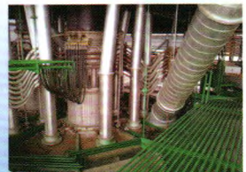
31500KVA锰硅合金电炉
