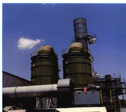
烟气脱硫、除尘设备
