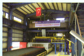
中钢设备承建的土耳其ISDEMIR 300平米烧结机
