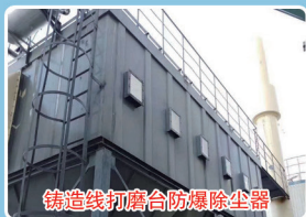
铸造线打磨台防爆除尘器
